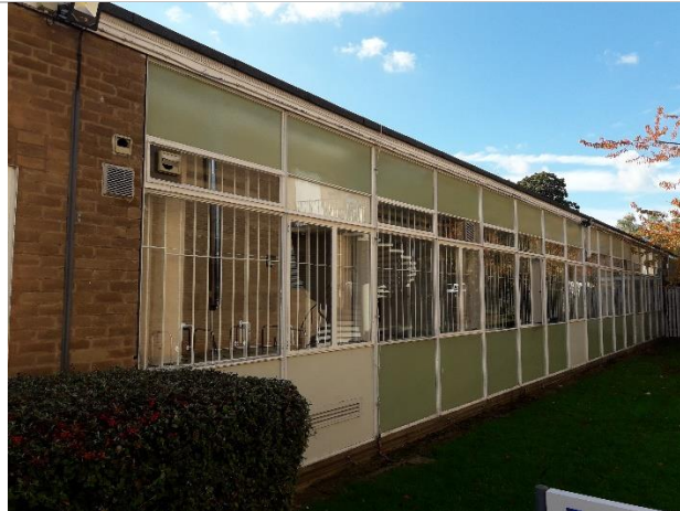
No edge protection
